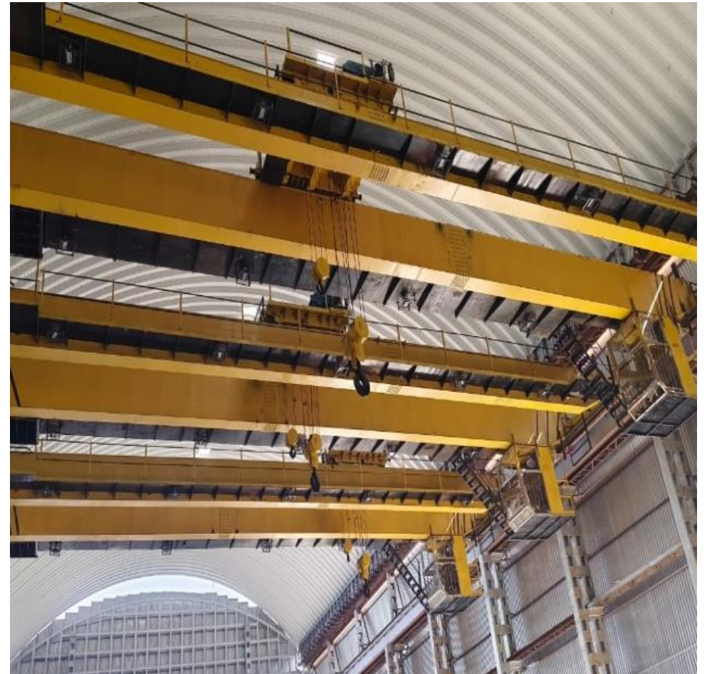
15/05 TON EOT CRANE
